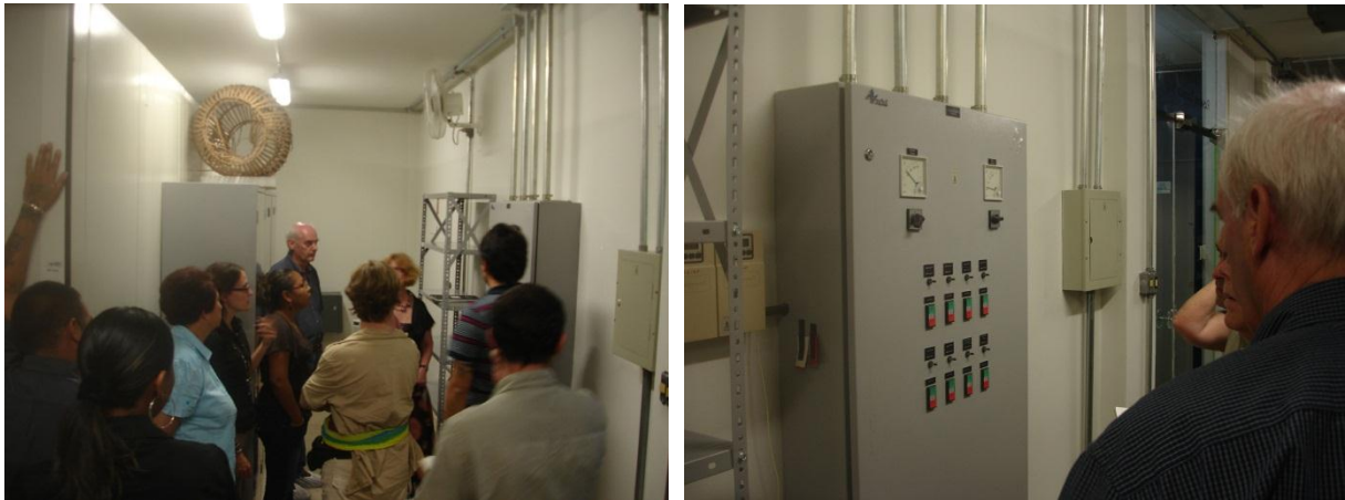
Explications du système de climatisation mécanique face au tableau de contrôle des hygrométries intérieures et extérieures au bâtiment des réserves.
